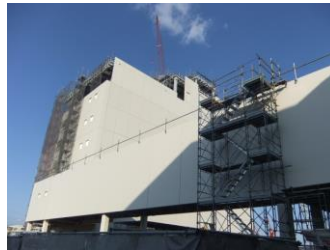
4号機燃料取出設備
